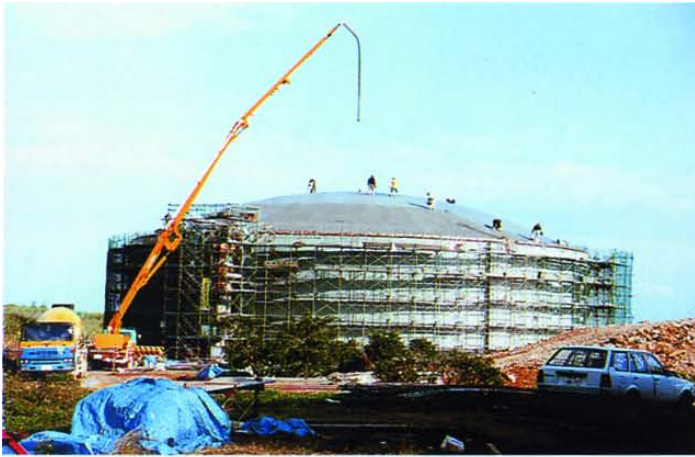
427 楚辺赤犬子原の貯水給水タンク。
