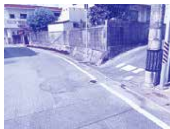
車輛が地面を擦る伊良皆区内、 今年度改良工事予定
