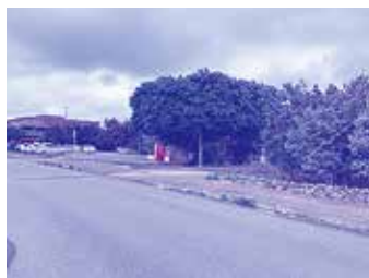
福祉センター駐車場トイレ横の点いてない水銀灯
