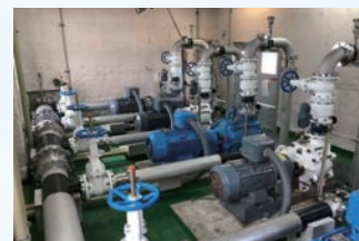
波平増圧ポンプ場
