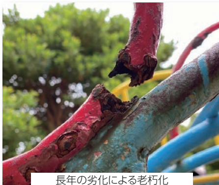
長年の劣化による老朽化
