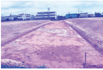
(仮称)村道比謝横断線が通る大木南区整理内の暫定道路予定地、長さ140m、幅員9m
