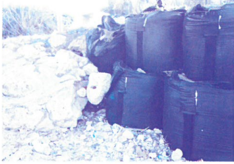
台風による侵食現場
