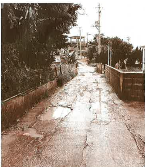
早急な整備が必要な古堅地域道路
