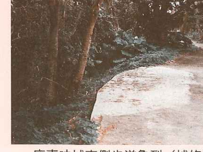
座喜味城東側歩道亀裂(補修済)
