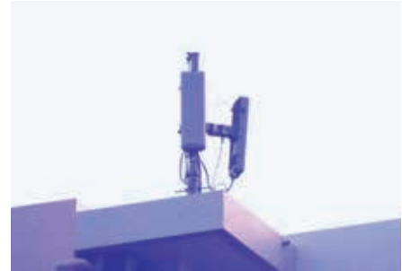
村内に設置された基地局アンテナ
