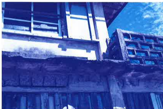
通学路に老朽化した建物を確認
