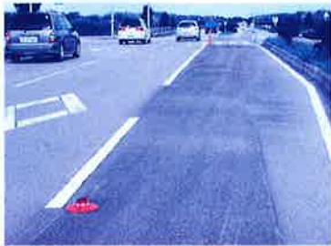
破損したポストコーン
