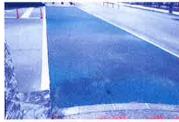
安全のため「路面舗装ゾーン」が必要
