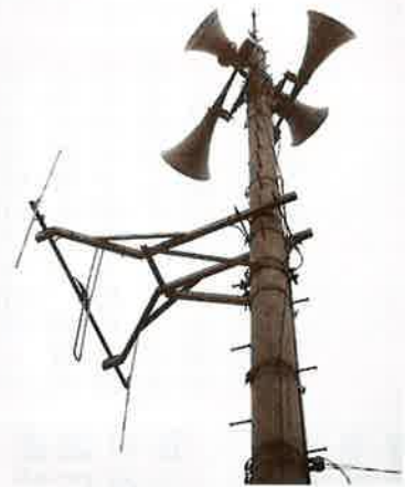
防災無線の増設・改善
