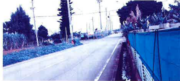
危険！村道波平残波線の排水路
