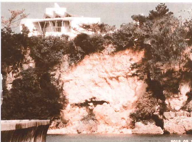
泊城公園崖地崩落対策調査委託事業
