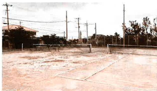
ネットも破れている、施設も壊れている、ナイターの設置も破れている、村内のテニスコート
